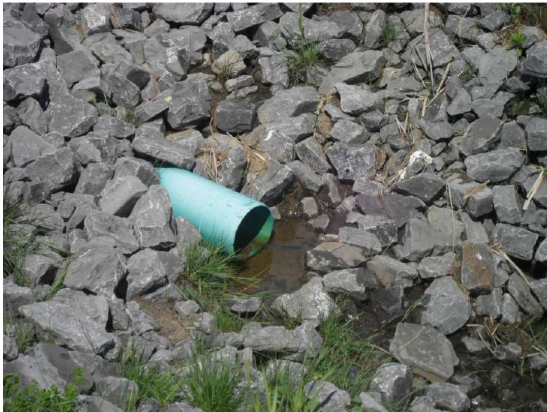
Figure 9 - Sortie du lit filtrant.
