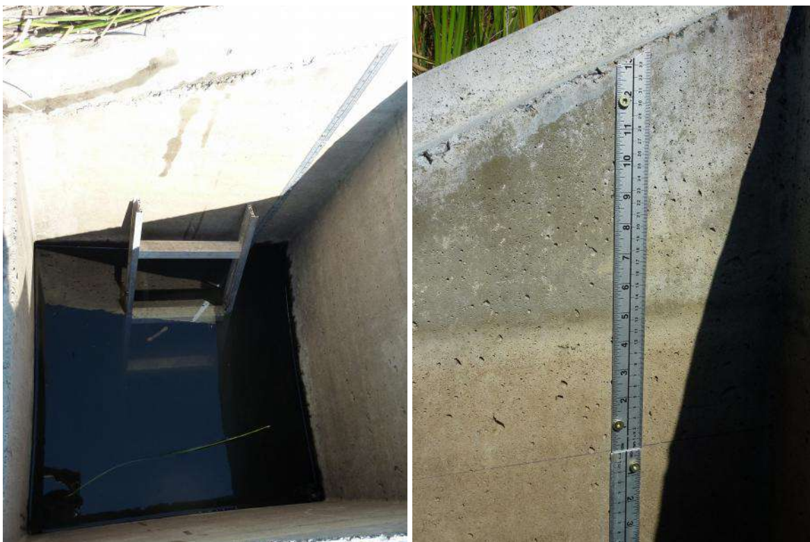
Figure 28 - Sortie du bassin de rétention vers lit filtrant actif avec baril et déversoir en V installé.
