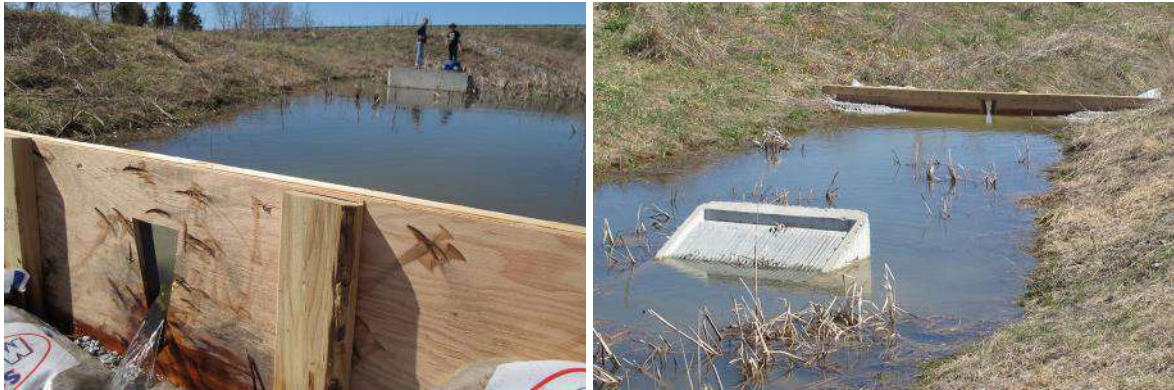
Figure 27 - Digue avec déversoir en V installé dans le fossé de trop plein du lit filtrant.
