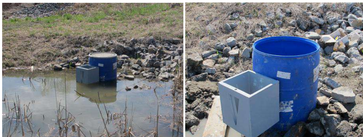
Figure 26 - Sortie du bassin de rétention vers lit filtrant actif avec baril et déversoir en V installé.
